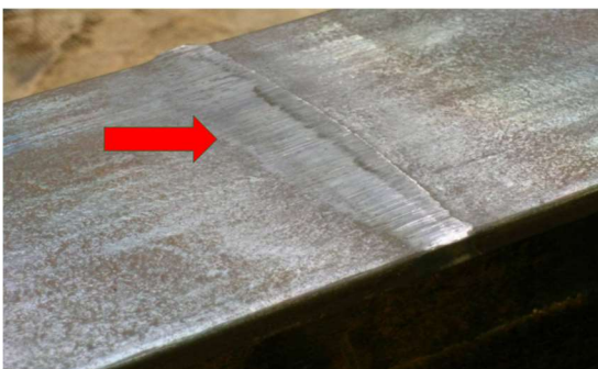
Figuur 2.101: Afschuijfout in voet (te laag)
