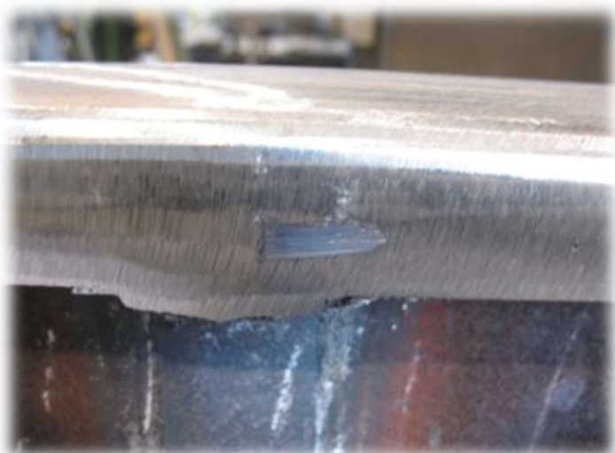
Figuur 1.78: Beschadiging bij thermietlas ten gevolge van het afstropen
