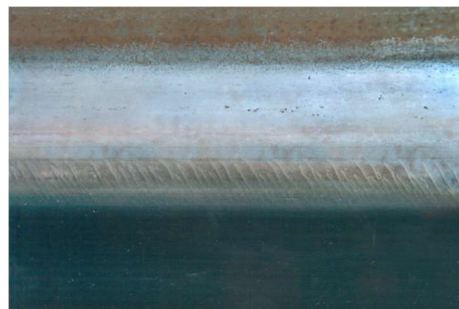
Figuur 1.55: Head checks in spoorstaaf
